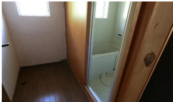
脱衣所・浴室
