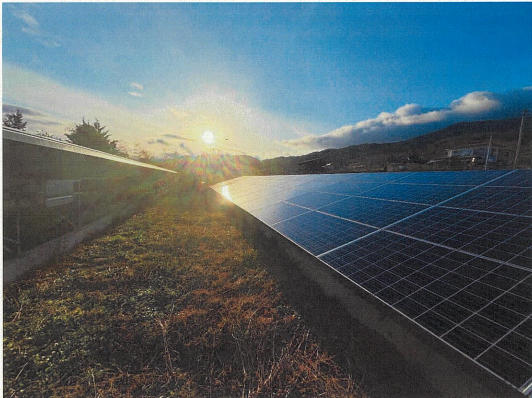
【参考】 シミュレーションから想定される反射光の角度と眩しさ (他の発電所で同条件の様子を撮影)
